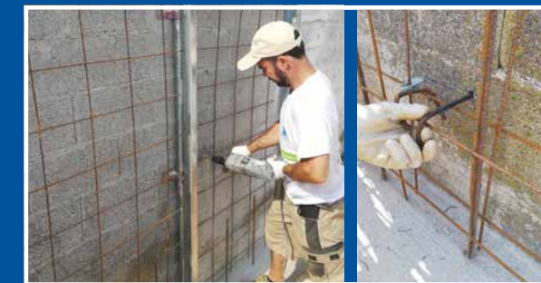
Posizionamento della rete metallica sulla parete e successivo inghisaggio dei connettori con ancoraggio chimico
